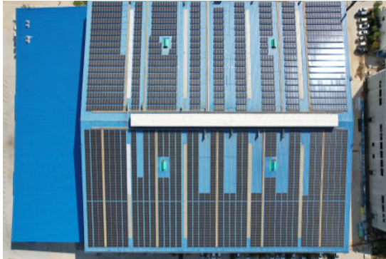
HOYA OPTICAL TECHNOLOGY (WEIHAI) CO., LTD.に設置した太陽光パネル（年間発電量：約1,300MWh、年間CO 2 削減効果：約800t-CO 2 ）
